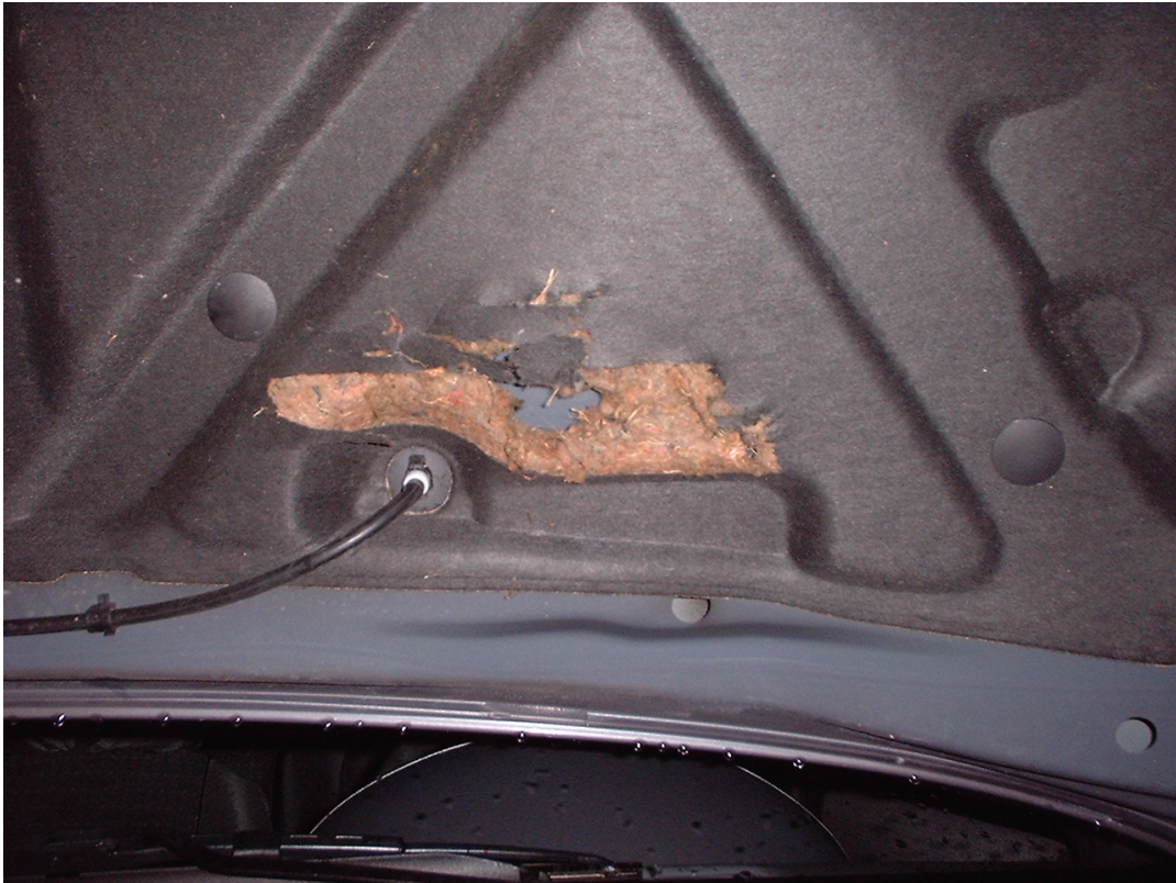
Beschadigde isolatie door krabben van steenmarter (foto: G. Miskens).
